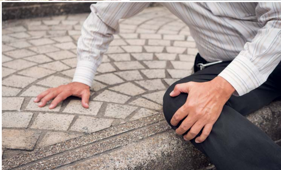
Sturzgefahr: Glatte Sohlen, unebener Untergrund oder Stolpern können die Ursache für Stürze sein.
